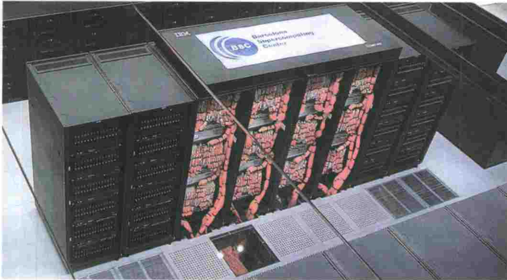
Vista de la sala de l'ordinador MareNostrum, a Barcelona Supercomputing Center - Centre Nacional de Computació
